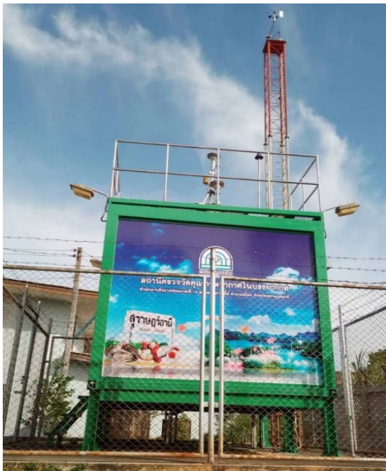
รูปที่ 29 สถานีตรวจวัดคุณภาพอากาศอัตโนมัติ จังหวัดสุราษฎร์ธานี
